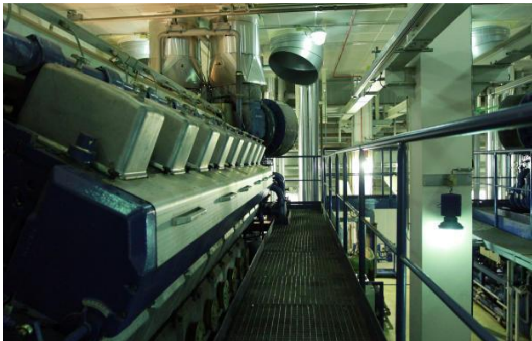
Diesellové agregáty v Plzeňské energetice zvládnou takzvaný start ze tmy.
